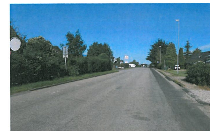
Figur 7: Brug for opfriskning af belægning og afmærkning i Saksild.
