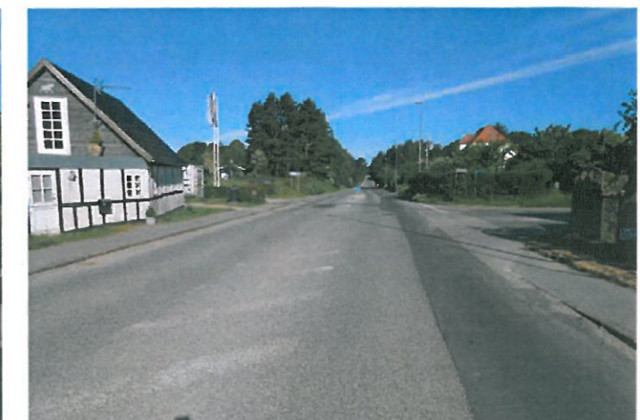
Figur 4: Der er brug for opfriskning af belægning og afmærkning i Rørth.
