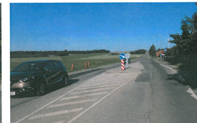
Figur 8: Brug for opfriskning af belægning og afmærkning i Saksild.
