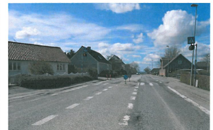
Figur 22: Belægning og afmærkning er i dårlig stand flere steder i byen.
