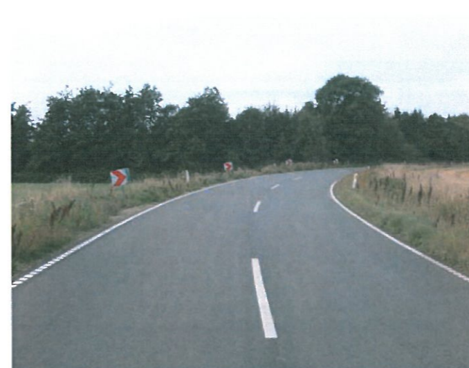
Figur 48: Tydelig baggrundsafmærkning (O41) ifm. skarp kurve
